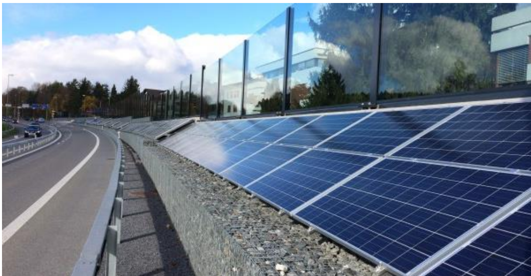
Abb. 24 Photovoltaikanlage integriert in eine Lärmschutzwand bei Zumikon (Quelle: naturschutz.ch)
