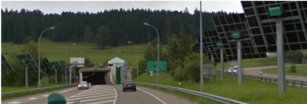
Abb. 23 Photovoltaikanlage am Tunnel Mont Sagne (Quelle: Google)
