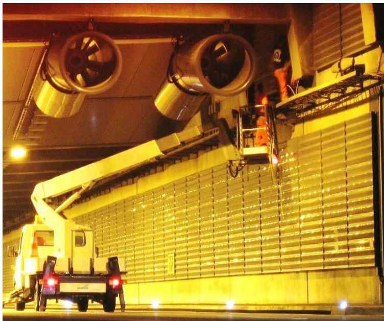
Abb. 30 Beispiel von Strahlventilatoren mit gekröpften Schalldämpfern
